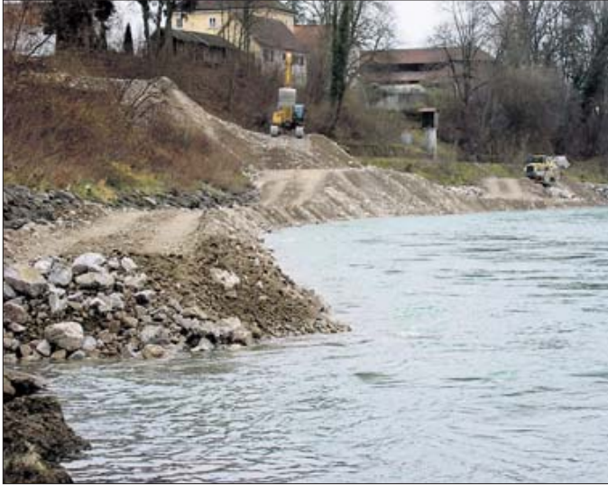
„Für die Salzach ist es fünf nach zwölf“: An manchen Stellen ist die Flusssohle bereits stark beschädigt. In Laufen wurde mit der Renaturierung begonnen. oh
